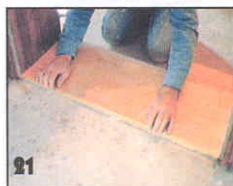
21 У края проступи верхней ступени крепят порожек из уголкового профиля. Точное положение порожка определяют при закрытой двери.
